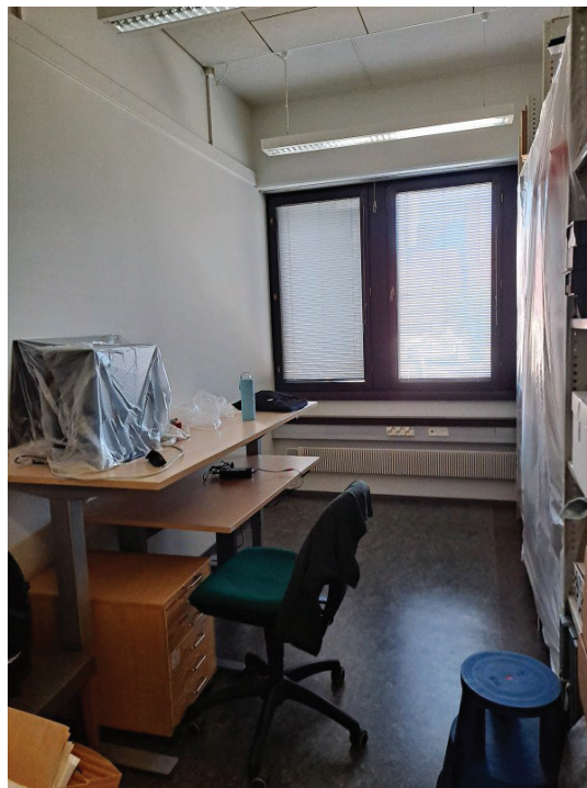
Kiinteistön kesäkuussa alkanut julkisivuremontti yllätti vuokralaiset, myös arkiston. Ikkunoiden kunnostuksen vuoksi työhuoneet jouduttiin ennen kesälomille lähtöä osin tyhjentämään tavarasta ja kalusteet suojaamaan. Kuva: Heta Tolvanen.
